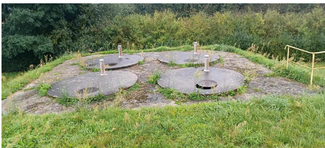
Zdj.6 Odstojnik popłuczyn ,składający się z 4 komór betonowych
