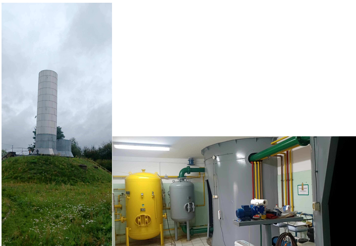
Zdj 4 i 5 . Widok Stacji Uzdatniania Wody typu Hydrofiltr, wraz z wewnętrznym wyposażeniem
